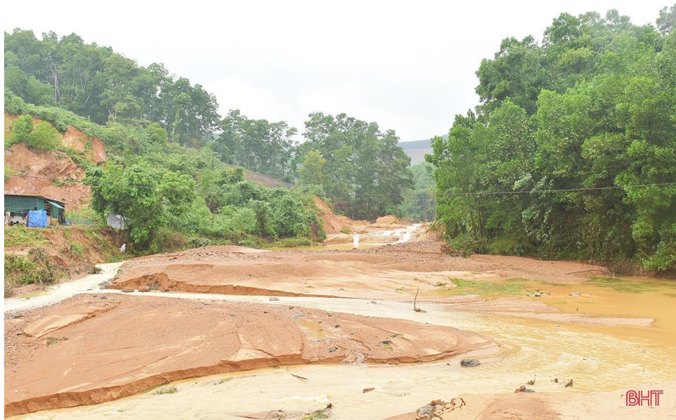
Đập Tát (xã Hòa Hải, huyện Hương Khê) bị vỡ thân đập trong ngày 30/10.
